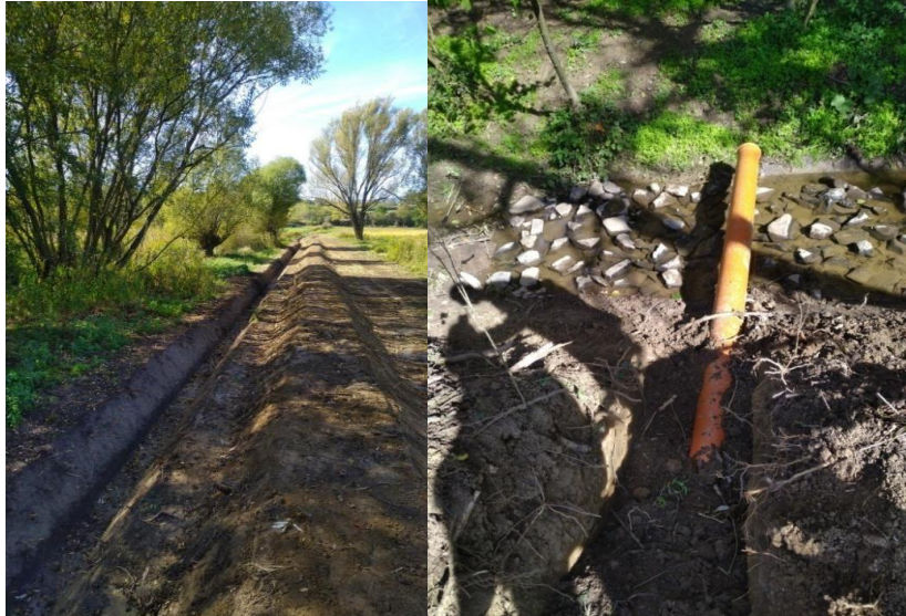
4. ábra Az árokrendszer és a megépülés alatt lévő fenékküszöb
