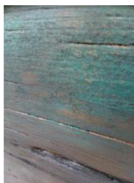
a. Longitudinal cracks
